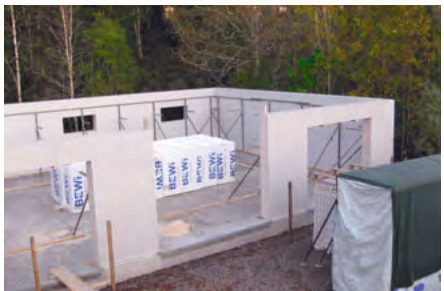
Ytterväggarna är 47 cm tjocka, uppbyggda av cellplastblock fyllda med 14 cm betong för att slippa skarvar, samt ytterligare 5 cm frigolitisolering både på insida och utsida.
