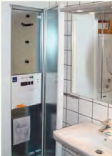
Ett FTX-aggregat tar inte stor plats. Det bör placeras lättillgängligt så att du enkelt kan byta filter.
